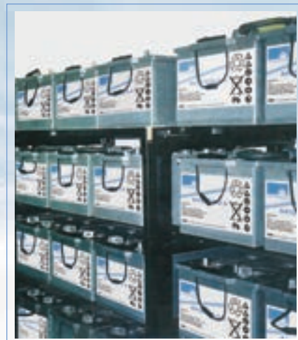
Рис. 14 Смонтированная батарея A400
