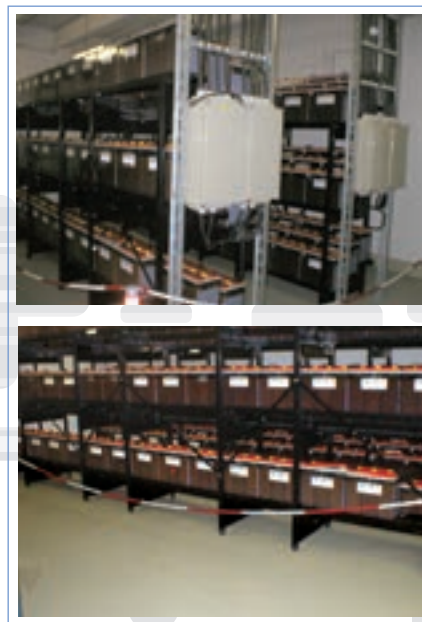
Рис. 23 Смонтированные батареи Classic Energy Bloc
