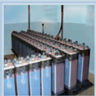
Рис.20 Смонтированная батарея Classic OPzS
