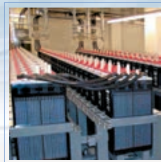
Рис. 17 Смонтированная батарея Classic OCSM
