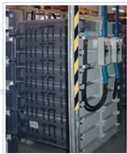
Рис. 10 Аккумуляторы Absolyte – установка в системе бесперебойного питания
