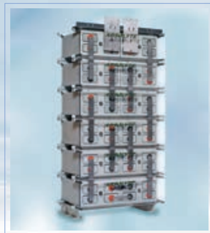
Рис. 8 Смонтированная батарея Absolyte
